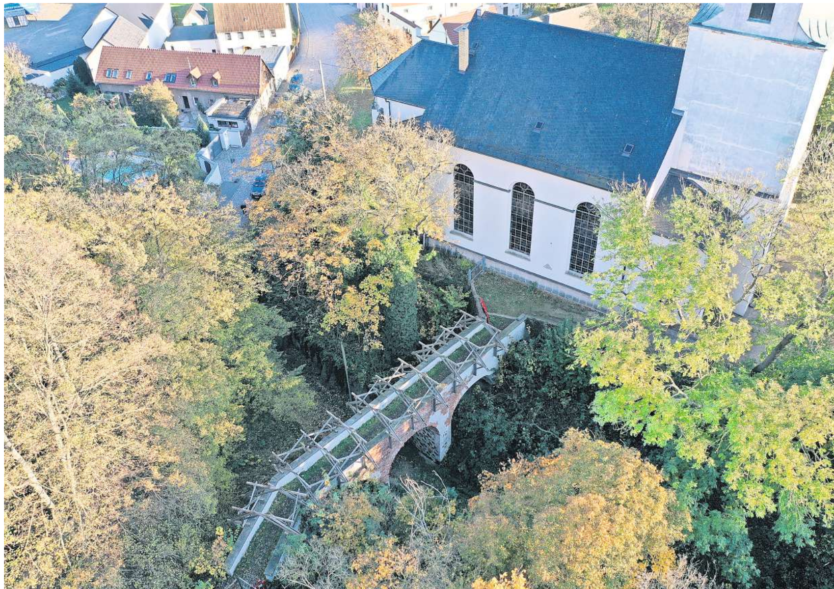
Für die Sanierung der Kirchbrücke Püchau stehen Gelder aus dem früherem SED-Vermögen bereit. Doch die Vorbereitung der Baumaßnahme ist zeitaufwendiger, als gedacht. FOTO: LUFTFLUG
